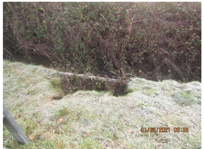
Anciennes « palplanches » implantée par la Commune.
